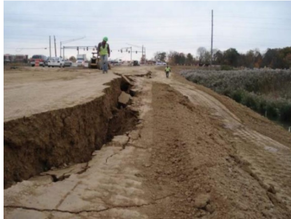
Foto 15. Nõrgale pinnasele (antud juhul turbale) ehitatud muldkeha on purunenud nõrga pinnase stabiilsuse kadumise tõttu. Foto allikast [7].
