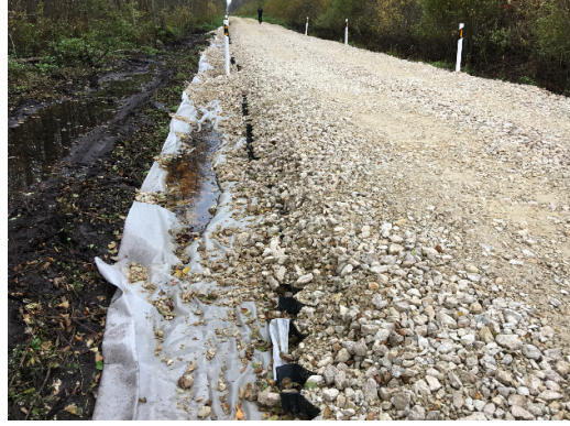
Foto 13. Geokärge on kasutatud kohas, kus suurvesi tõuseb teest kõrgemale. Eesmärgiks on hoida tee konstruktsioon madalana ja hoida jämetäitematerjali kinni. Foto: Sven Sillamäe.
